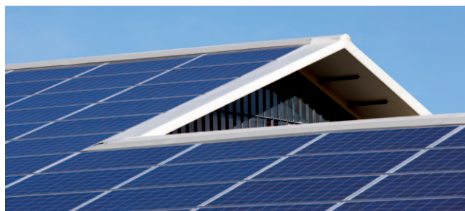
Impianto fotovoltaico ad integrazione totale installato su pannello Isocop-5 e su LG 40
